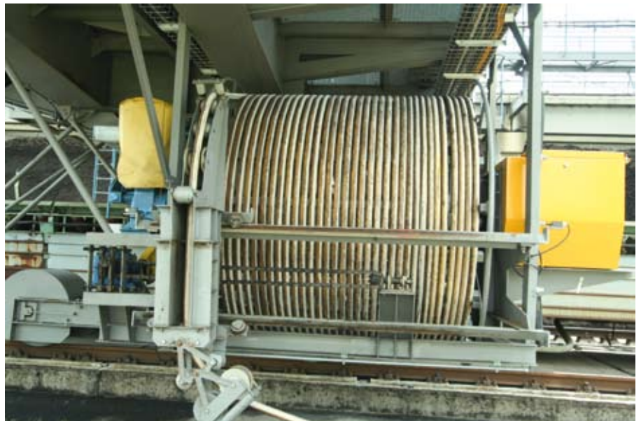
Bild 2. Ein Beispiel für den praktikablen Einsatz von Wireless-Technologien ist der Ersatz von Schleppkabeln durch Funkstrecken bei mobilen Großgeräten wie Abräumer im Kohle-Tagebau, wobei angesichts des für Kabel und Trommel erforderlichen Aufwands Einsparungen im vierstelligen Euro-Bereich realisierbar sind. Weitere Einsatzbereiche für den Ersatz von Schleppkabeln oder Schleifkontakten sind zum Beispiel Kläranlagen und alle Arten von Kran- und Hebeeinrichtungen.
